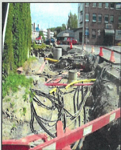
Entreprenøren har ansvar for å halde oversikt over kva som ligg i grunnen der det skal gravast.
